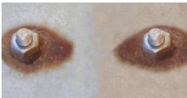
Рисунок 9. Пример контактной коррозии
